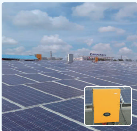
• Rudong, China 1.1MW
